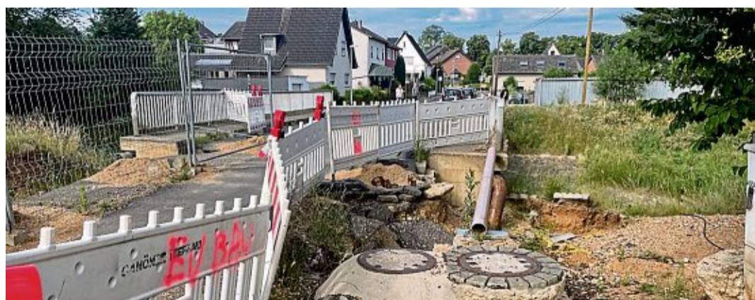
Die Brücken an Drei-Eichen-Straße und Bergstraße sollen bald saniert werden.
